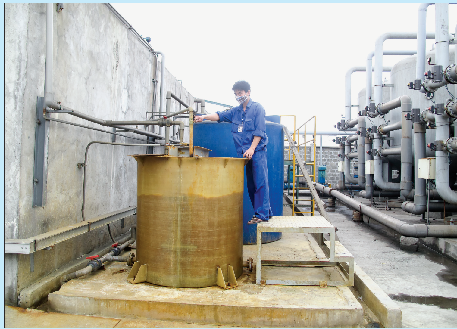
Hệ thống xử lý nước thải của Công ty TNHH may NienHsing.
