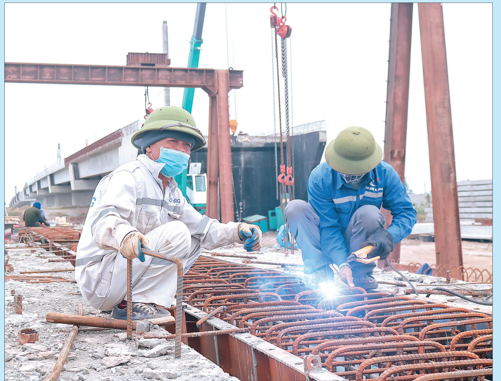
Đơn vị thi công đẩy nhanh tiến độ thi công các hạng mục cuối của cầu Diêm Điền.
