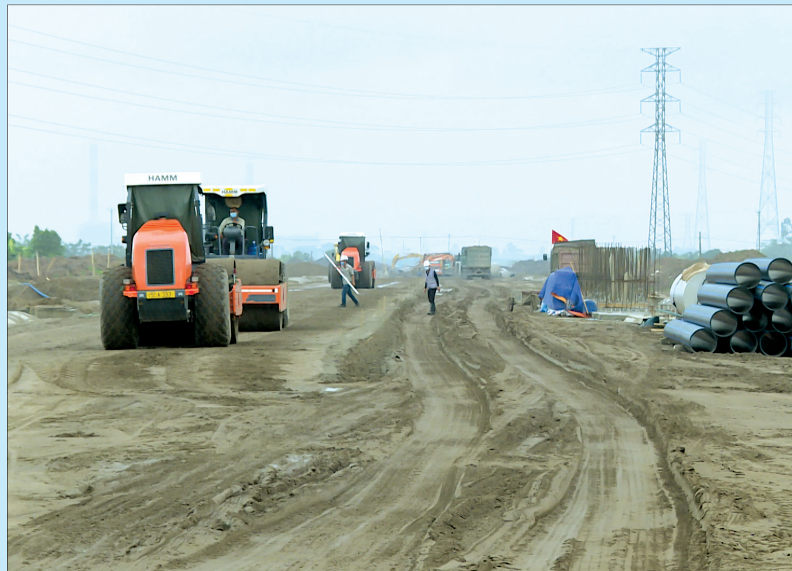
Xây dựng hạ tầng khu công nghiệp - đô thị - dịch vụ Liên Hà Thái.
