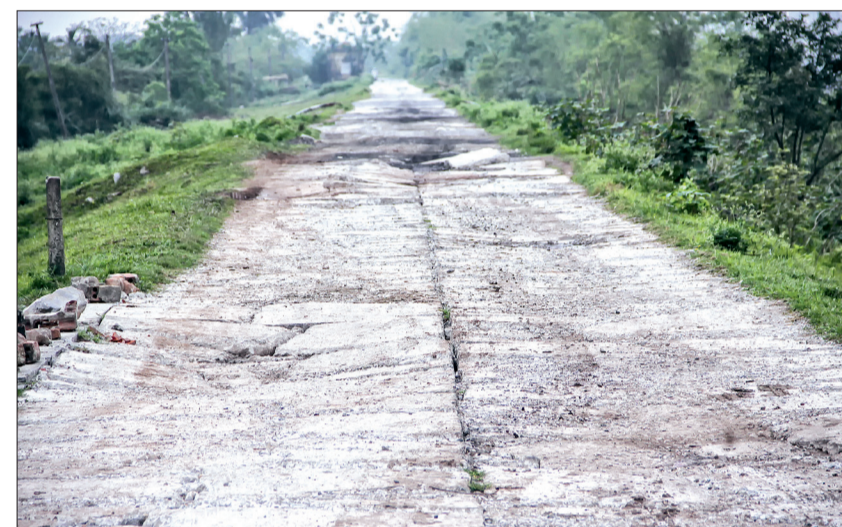
Mắt đê tả Trà Lý đoạn qua địa phận xã Đông Hòa (thành phố Thái Bình) xuống cấp nghiêm trọng.
