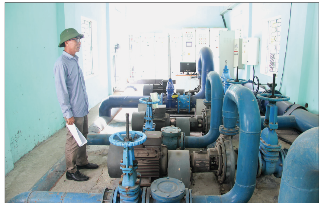
Hệ thống máy bơm tăng áp của Xí nghiệp nước Tiên Hải.
