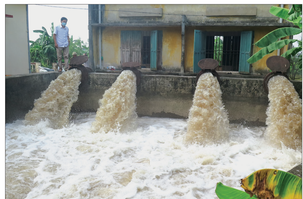
Trạm bơm Diệm Dương (xã Trà Giang) tiêu thoát nước khi có mưa lớn xảy ra.
