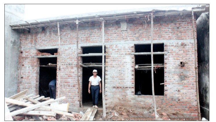
Căn nhà của ông Đào Xuân Sinh, thương binh hạng 2/4, xã Nam Trung (Tiền Hải) đang được hoàn thiện.
