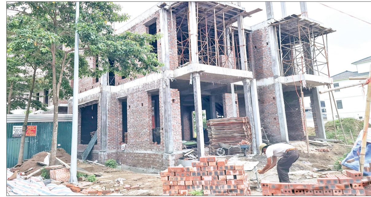
Giá trị xây dựng công trình đội lên từ 20 - 40% khiến người dân, doanh nghiệp gặp khó khăn.
