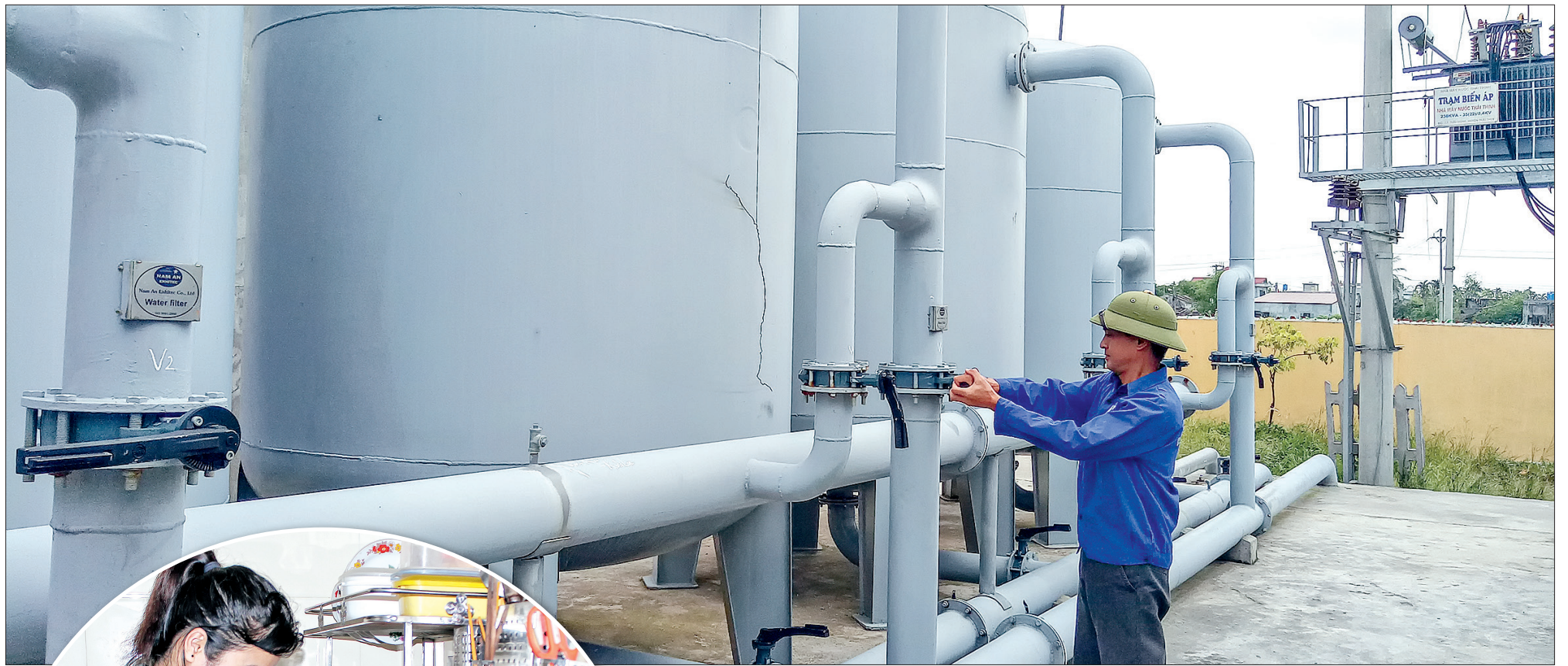
Hệ thống xử lý nước của nhà máy nước sạch sinh hoạt Thái Thịnh.
