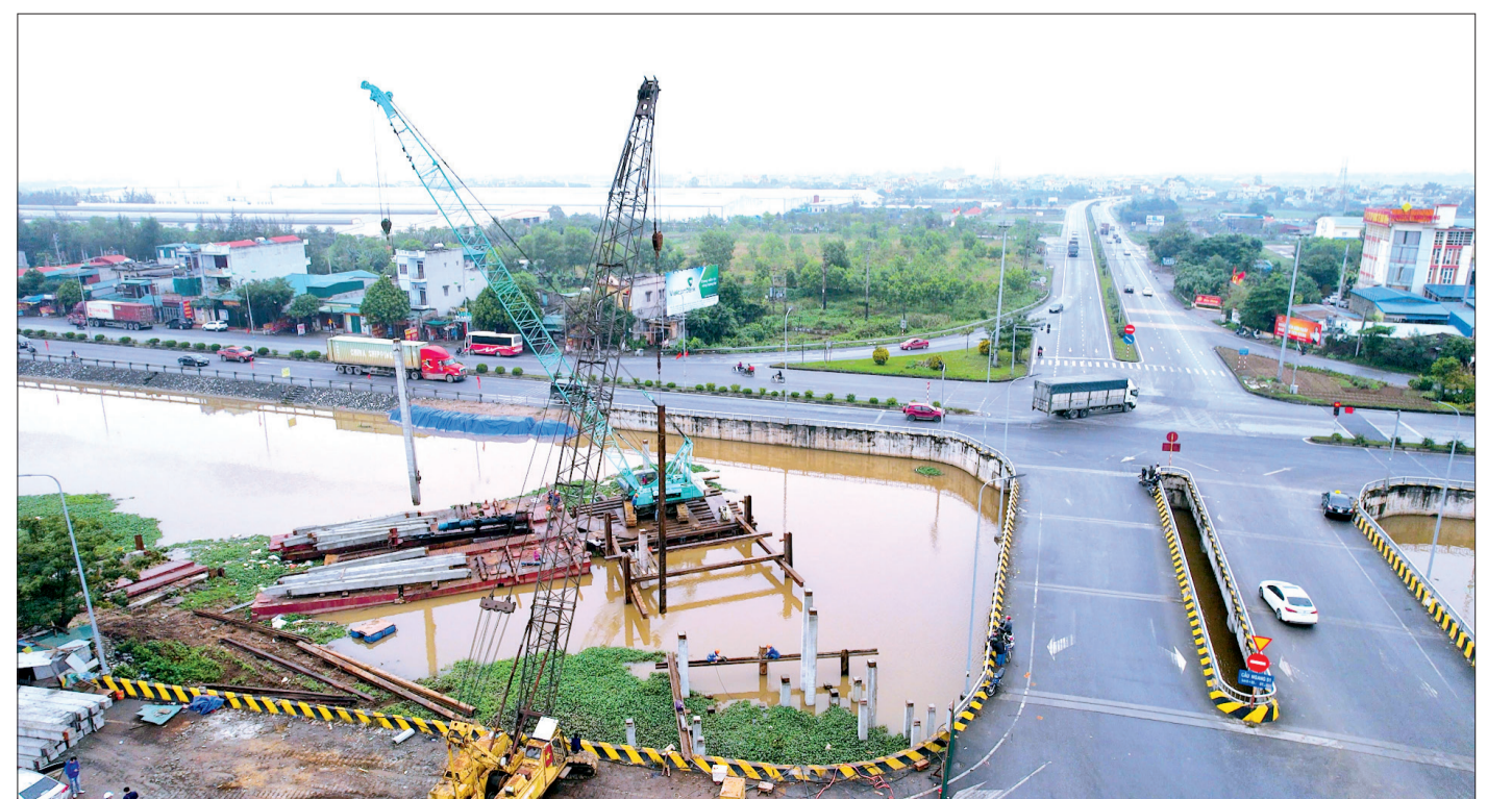
Thi công hạng mục cầu ngang S1, thuộc dự án đầu tư xây dựng tuyến đường vành đai phía Nam thành phố Thái Bình, đoạn từ cầu ngang S1 đến đường Chu Văn An kéo dài.
