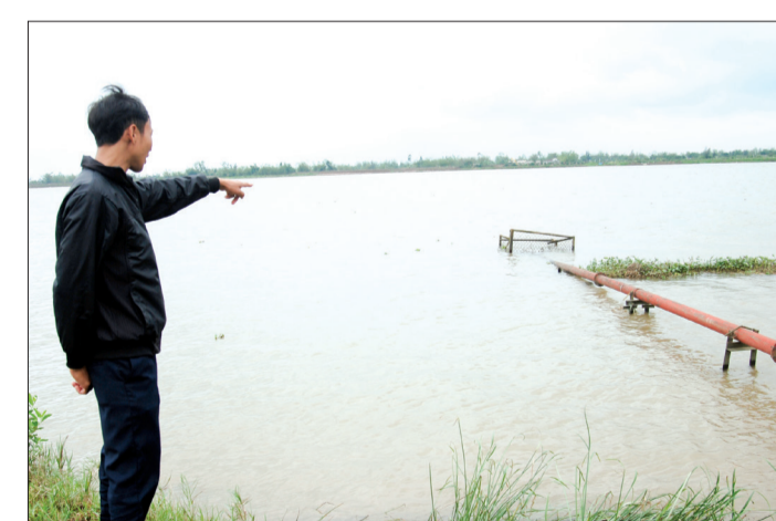
Ông bơm của trạm cấp nước Minh Tân treo lơ lửng trên mặt sông vì đất bãi bị sạt lở.
