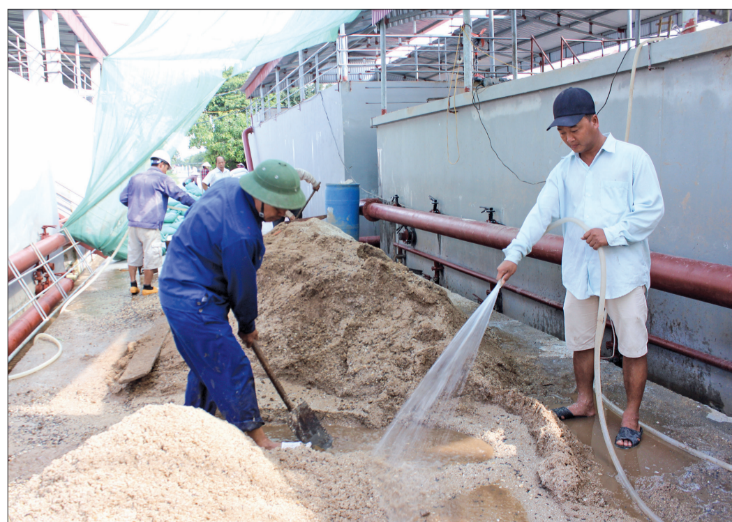
Công nhân nhà máy nước sạch Thành Thụy (xã Thụy Ninh, huyện Thái Thụy) sục rửa cát bổ sung vào hệ thống bể lọc nước tại nhà máy.
