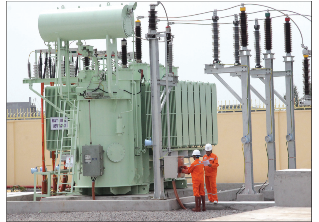
Công nhân Công ty Điện lực Thái Bình kiểm tra hoạt động tại trạm biến áp 110kV.
