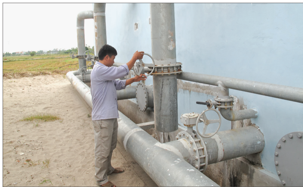
Công nhân nhà máy nước sạch của Công ty Cổ phần Casaro miền Bắc vận hành hệ thống nước sạch.
