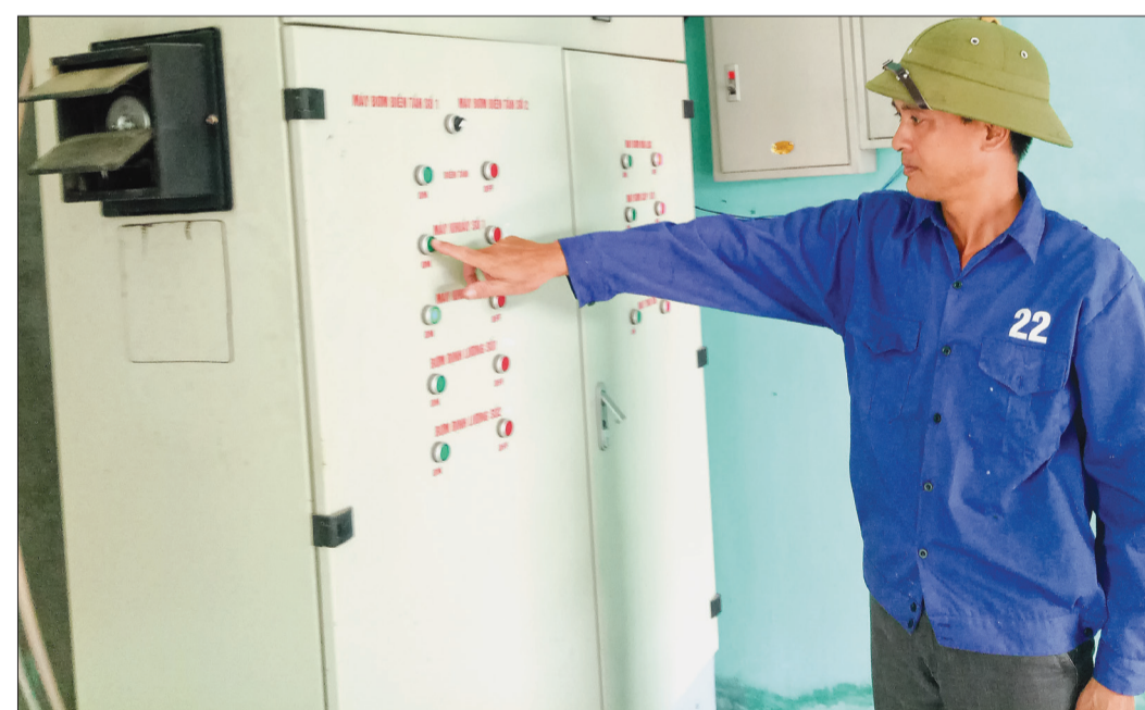
Công nhân nhà máy nước sạch sinh hoạt Thái Thịnh (Công ty TNHH Toàn Thịnh) vận hành sản xuất.
