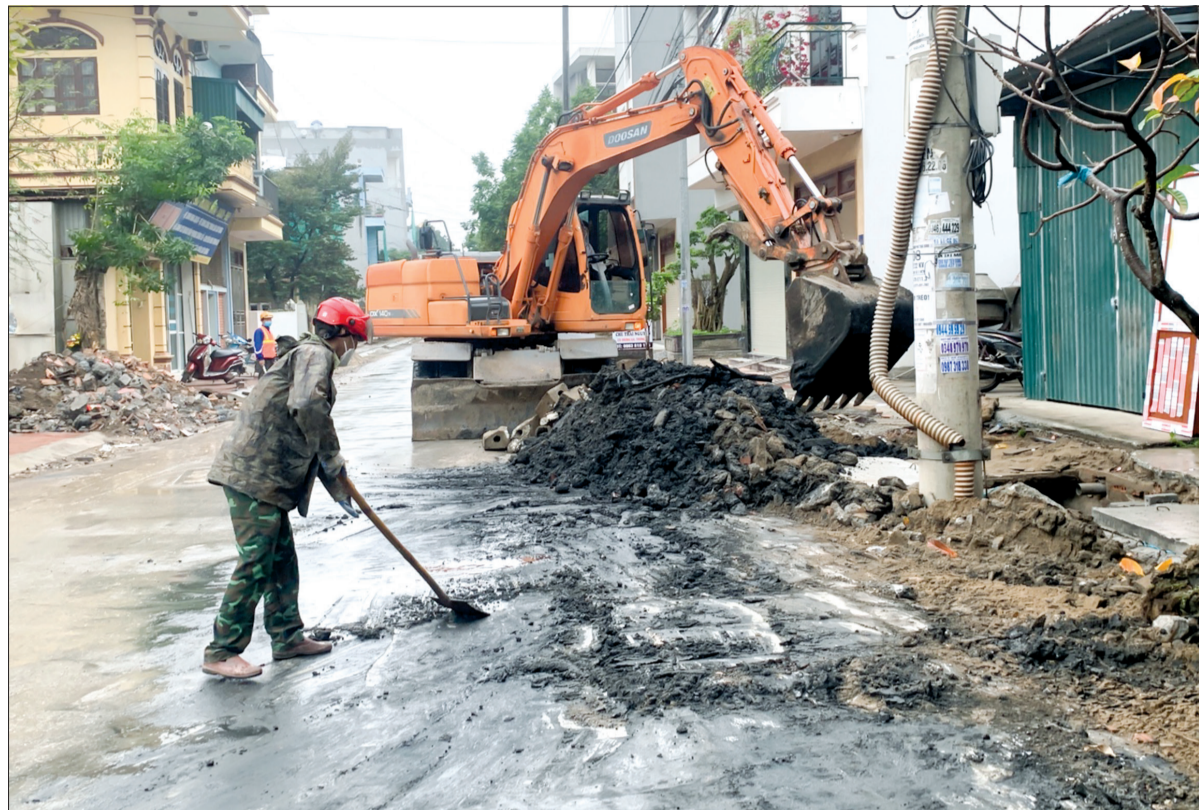
Dự án cải tạo, sửa chữa đường Ngô Thì Nhậm sẽ được điều chỉnh một số nội dung để đáp ứng yêu cầu chống ngập.
