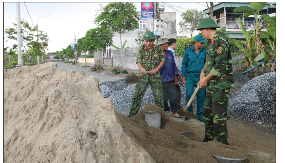
Các chiến sĩ tham gia xây dựng nhà tình nghĩa cho hộ có hoàn cảnh khó khăn trên địa bàn thành phố.
