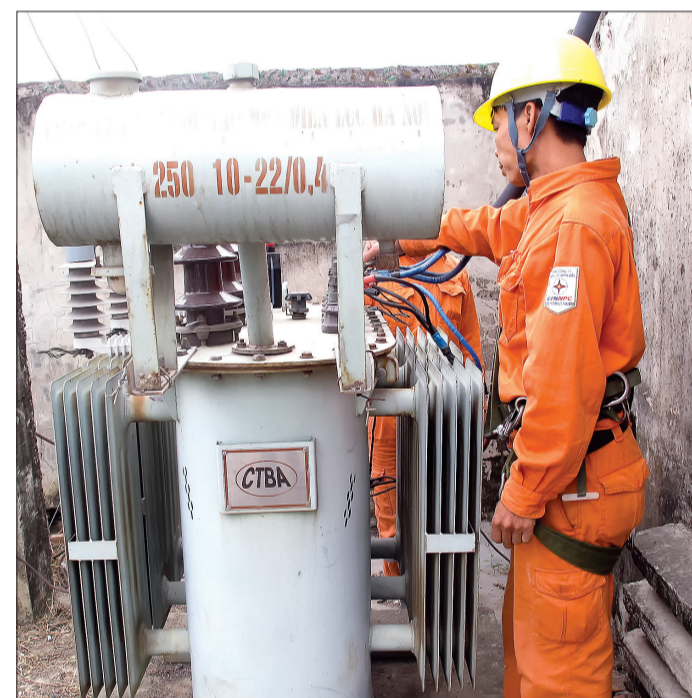
Công nhân Điện lực Thái Thụy kiểm tra trạm biến áp.
