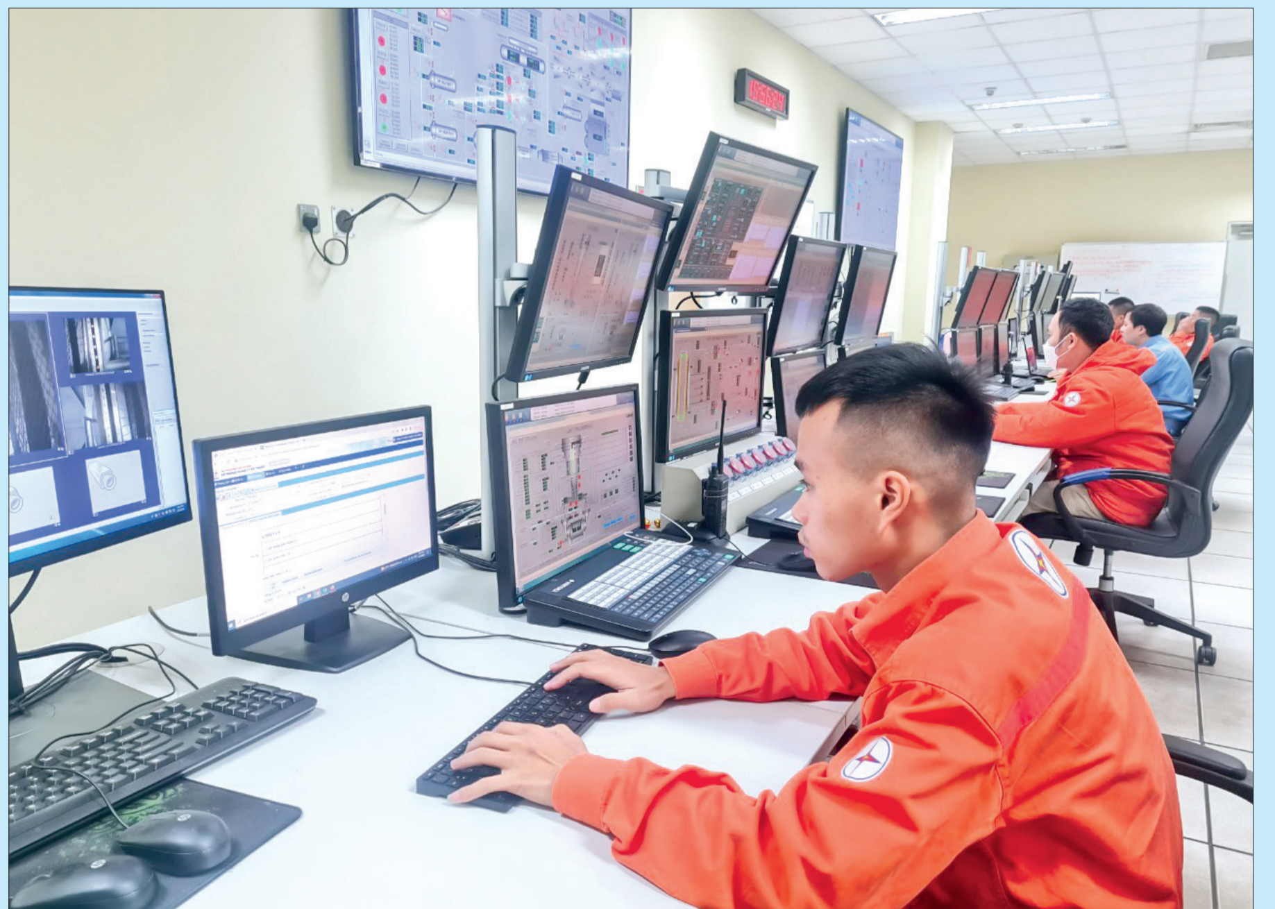
Khu vực điều hành hệ thống điện của Công ty Nhiệt điện Thái Bình.
