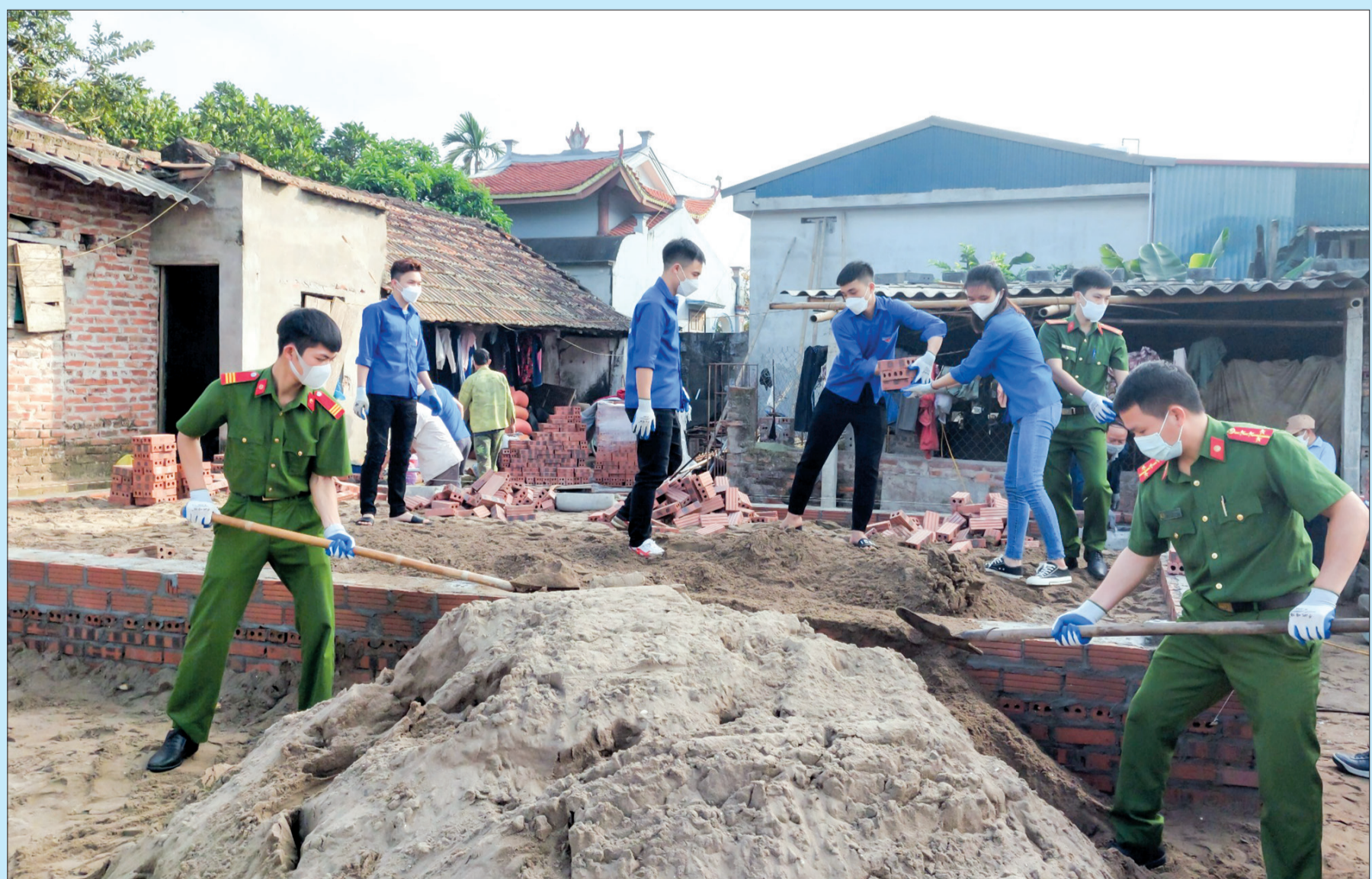
Đoàn viên, thanh niên hỗ trợ ngày công xây nhà cho gia đình học sinh có hoàn cảnh khó khăn tại xã Minh Lăng (Vũ Thư).
