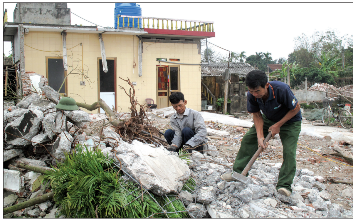
Người dân xã Đông La (Đông Hưng) tự nguyện tháo dỡ nhà cửa, công trình, bàn giao mặt bằng cho đơn vị thi công. Ảnh tư liệu
