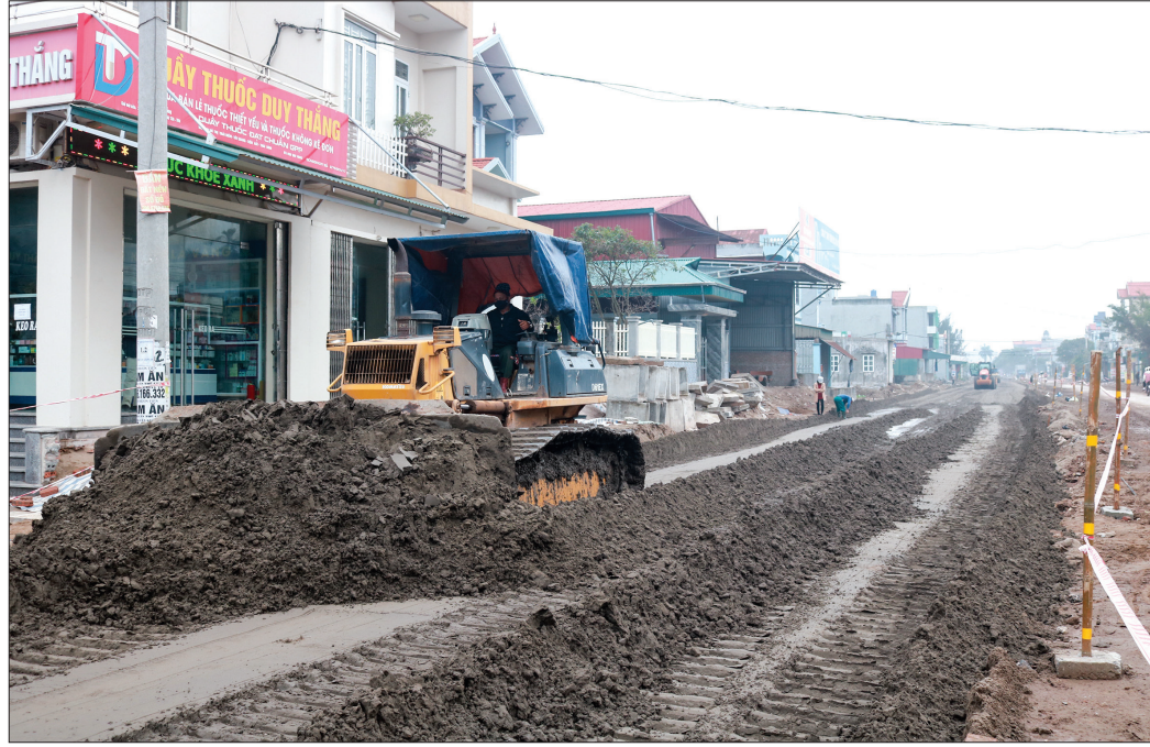
Tuyến đường 221A đang bước vào giai đoạn thi công nước rút.
