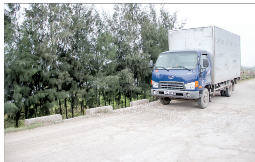
Tình trạng đê biển xuống cấp.
