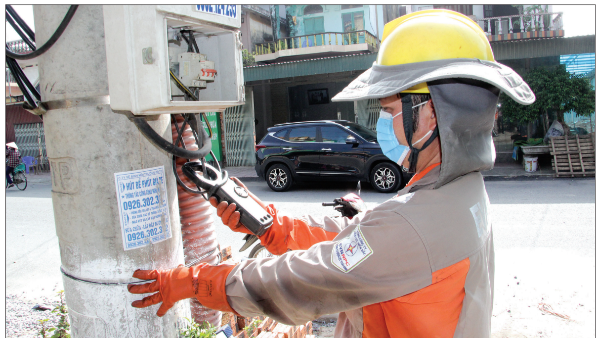
Công nhân Điện lực Hưng Hà kiểm tra hoạt động công tơ điện tử đo xa.
