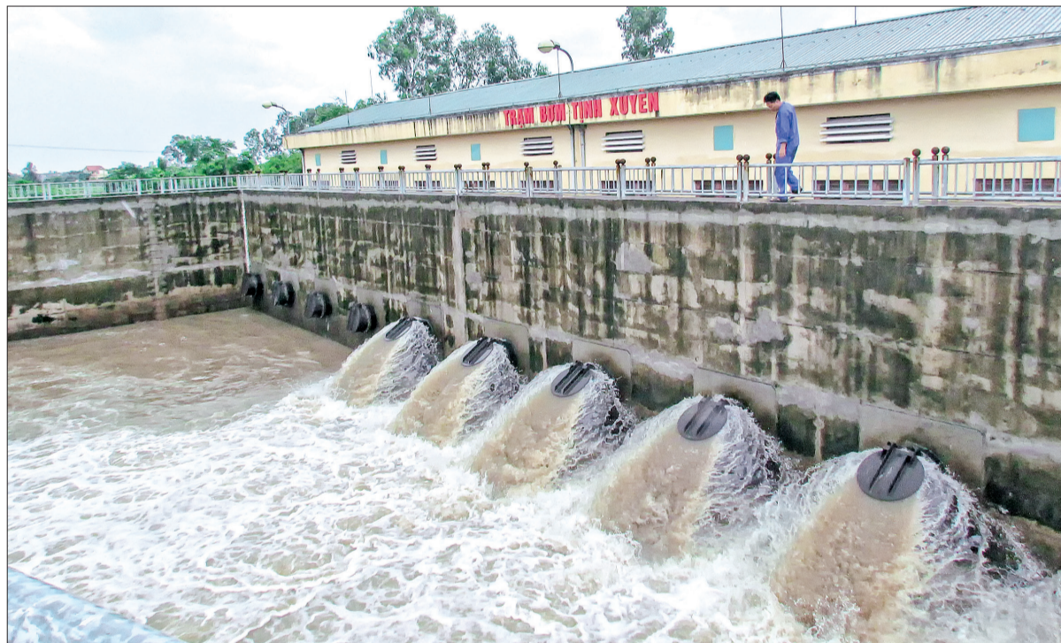
Trạm bơm Tịnh Xuyên (Hưng Hà) vận hành tiêu nước.
