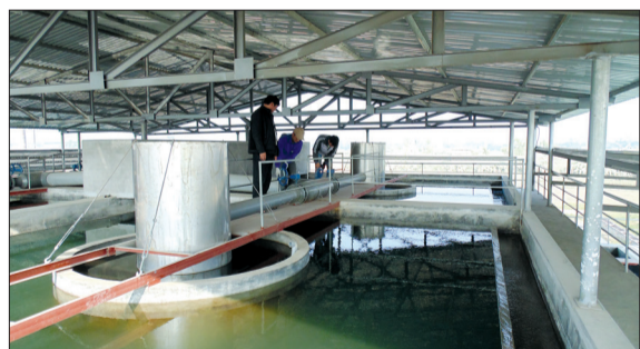
Hệ thống cấp nước sạch của Công ty TNHH MTV Kinh doanh nước sạch Thanh Sơn (xã Quỳnh Giao, huyện Quỳnh Phụ).
