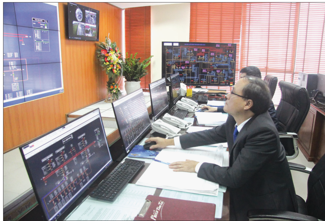
Cán bộ Trung tâm điều khiển xa, Công ty Điện lực Thái Bình kiểm tra hoạt động hệ thống quản lý cung cấp điện trên địa bàn tỉnh.
