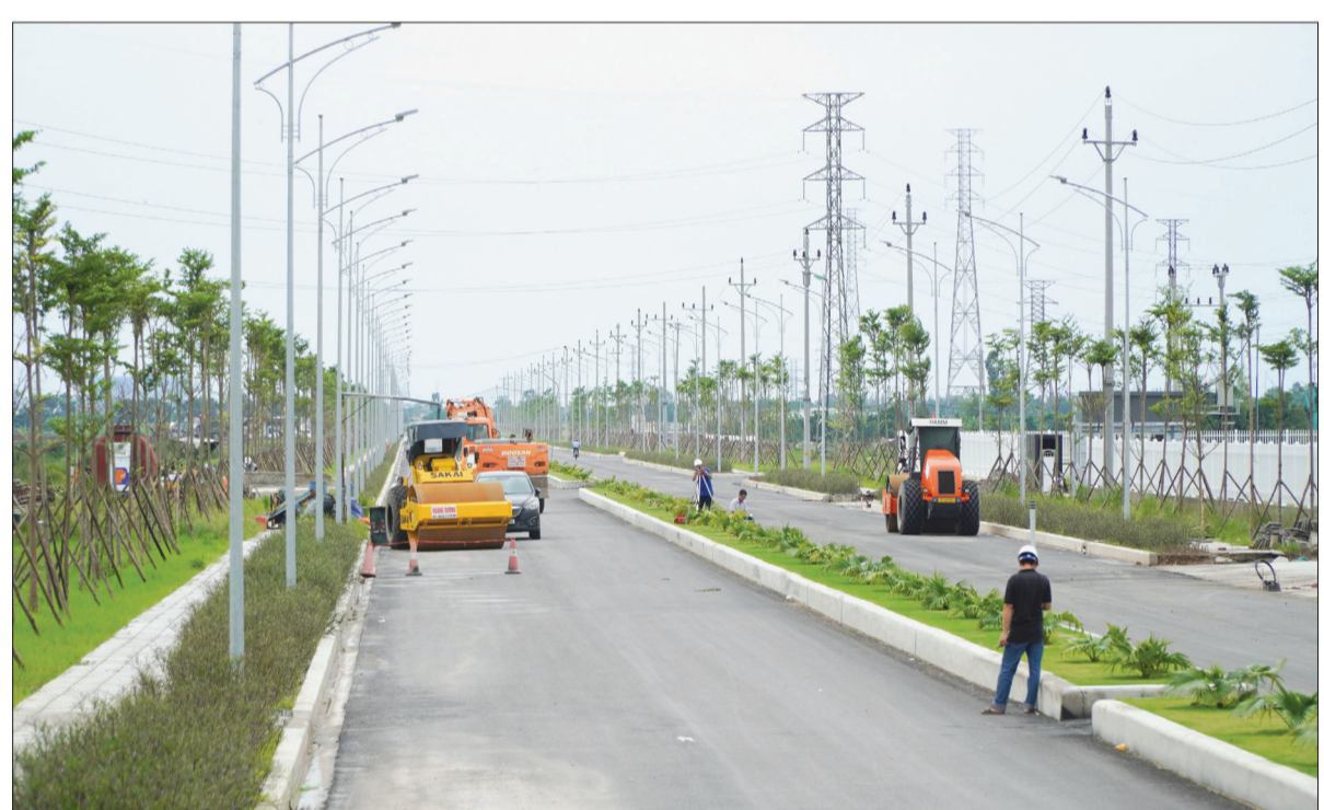
Khu công nghiệp Liên Hà Thái có hạ tầng kỹ thuật đồng bộ, hiện đại giúp các dự án thủ cấp thuận lợi trong đầu tư xây dựng, sản xuất, kinh doanh.
