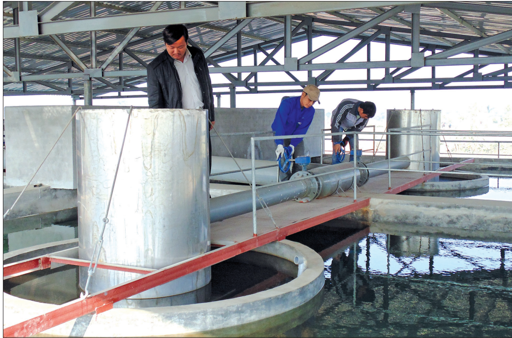
Nước máy phủ kín 100% xã, phường, thị trấn.
