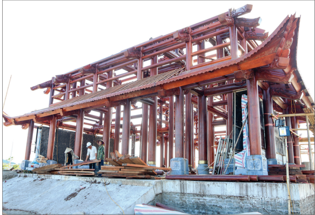
Hạng mục đến chính của Đền thờ Mẹ Việt Nam anh hùng đã cơ bản dựng xong phần gỗ và cất nóc vào ngày 27/8.
