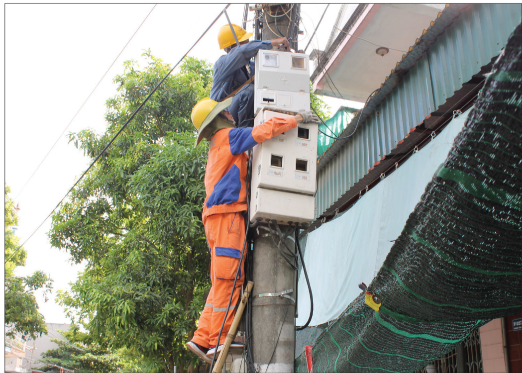
Điện lực thành phố Thái Bình tổ chức kiểm tra, bảo dưỡng hệ thống đường dây hạ thế khu vực thị trấn Vũ Thư.
