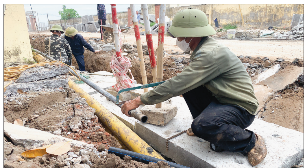
Nhà máy nước sạch Thành Thủy khắc phục sự cố vỡ đường ống nước.
