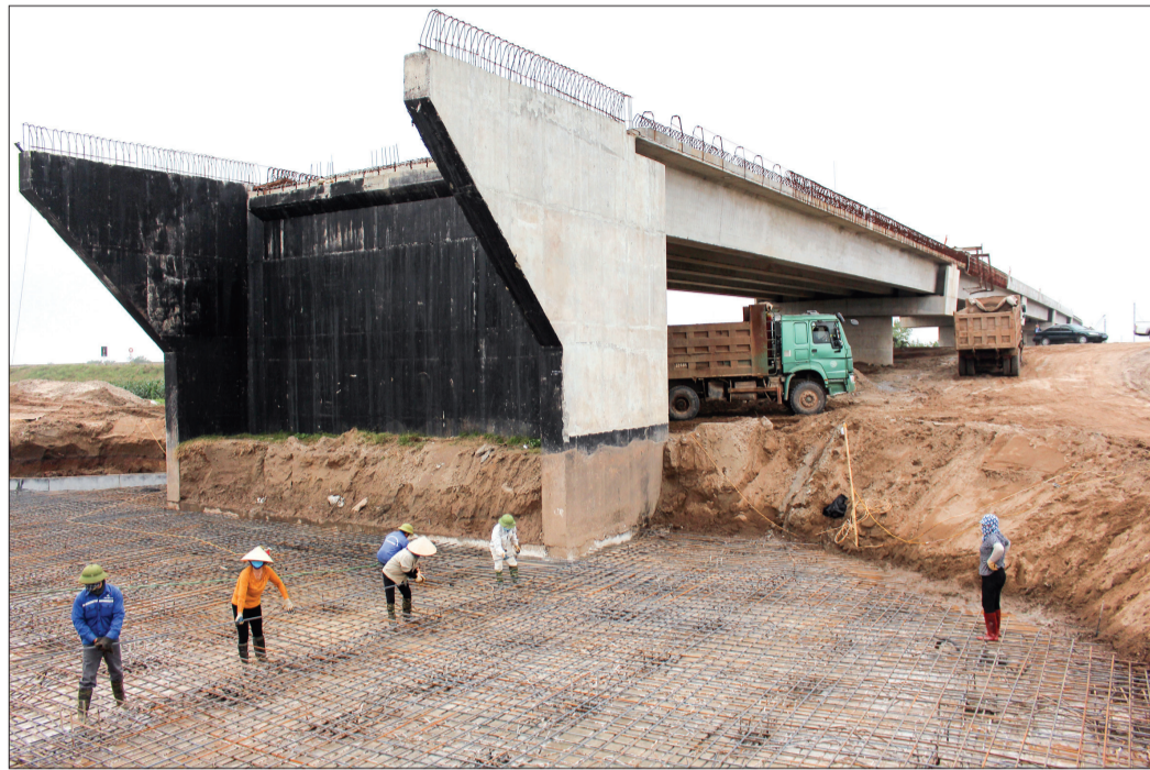
Thi công cầu Diêm Điền thuộc dự án tuyến đường bộ ven biển tỉnh Thái Bình.
