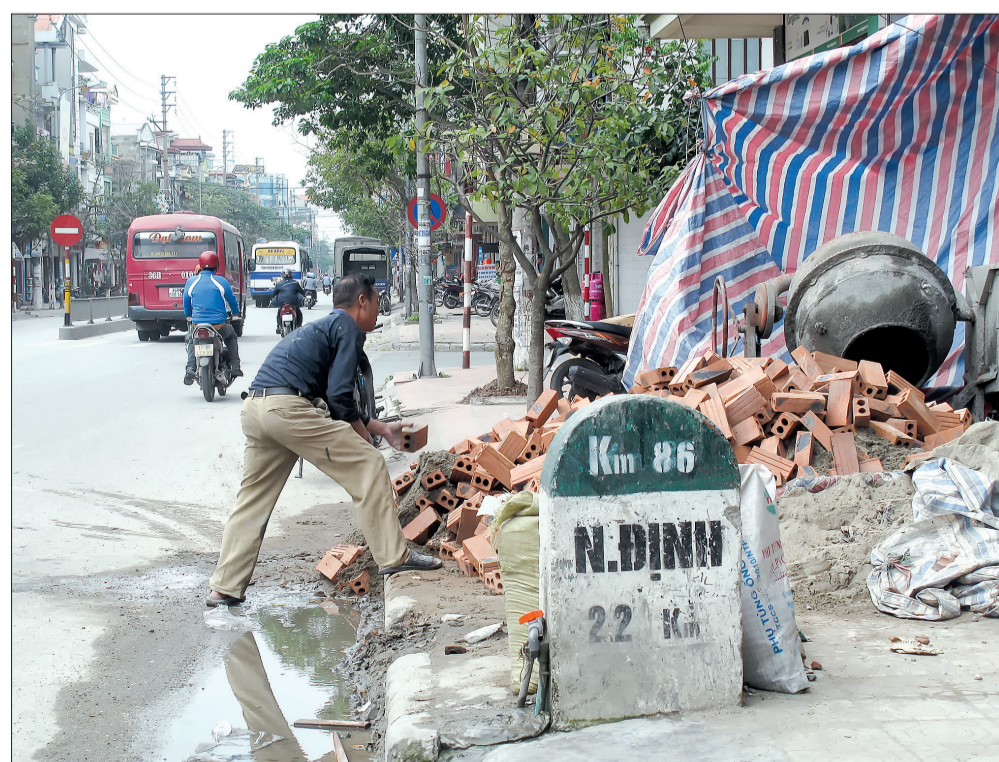
Bày vật liệu xây dựng trên vỉa hè đường Trần Thái Tông.
