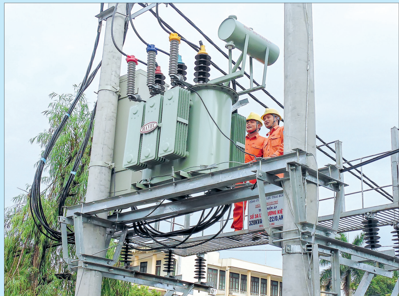
Công nhân Điện lực thành phố xử lý sự cố tại trạm biến áp.
