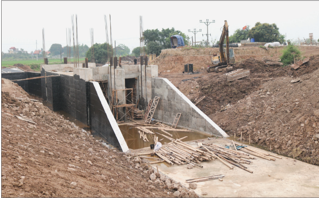
Công trình thủy lợi cống Mang tại K14+350 thuộc xã An Mỹ (Quỳnh Phụ) được đầu tư xây mới góp phần phục vụ tưới, thoát nước cho nhiều địa phương trong huyện.
