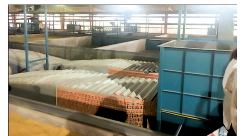
Hệ thống lò đốt và thùng chứa.
