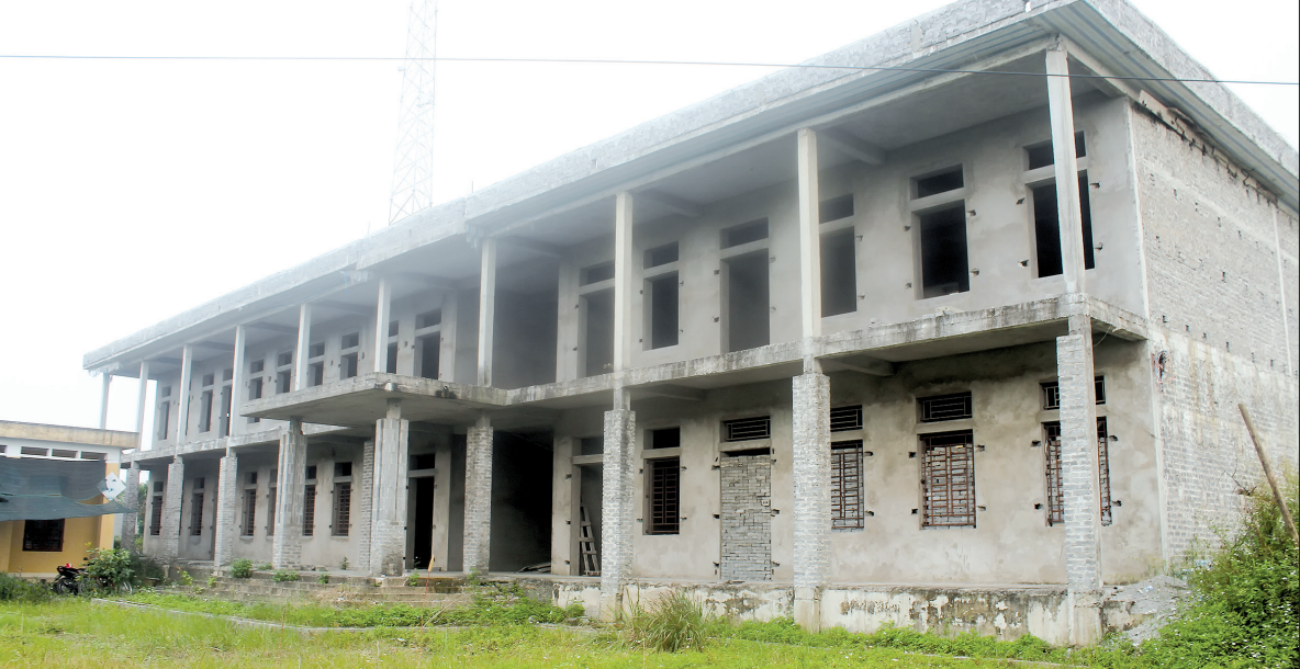
Trường Mầm non Minh Tân (Đông Hưng) xây dựng hơn 3 năm chưa xong.
