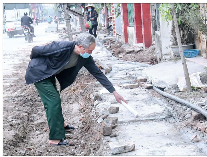
Một đoạn cống đã hoàn thành nhưng làm mất mỹ quan đô thị, chưa bảo đảm chất lượng.
