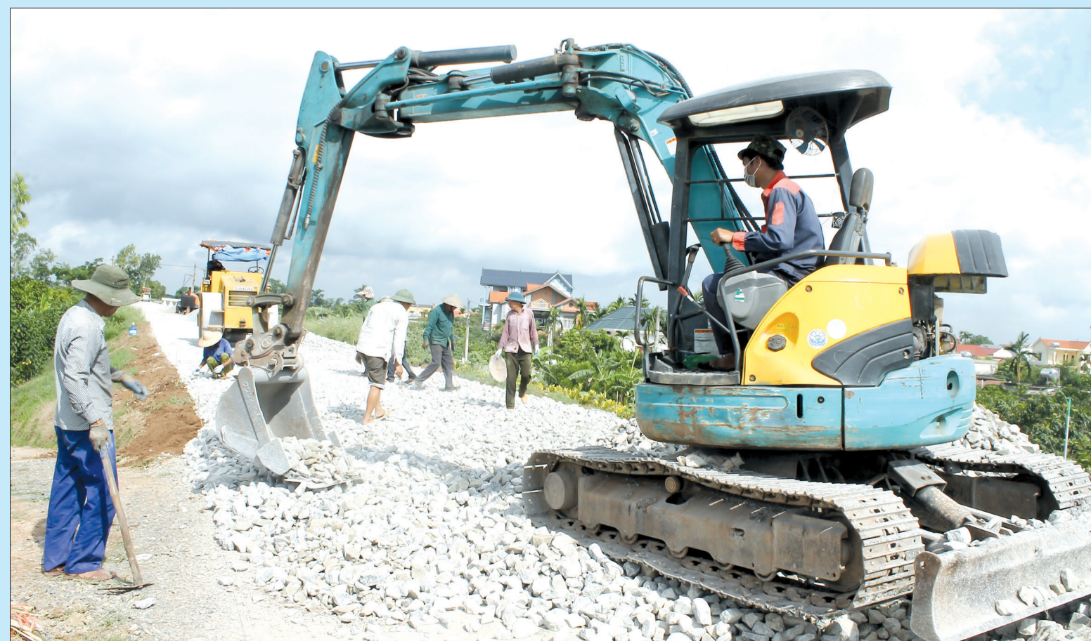
Đẩy nhanh tiến độ thi công tuyến đê tả Hồng Hà II đoạn qua địa bàn xã Việt Hùng (Vũ Thư) để hoàn thành trước mùa mưa bão.
