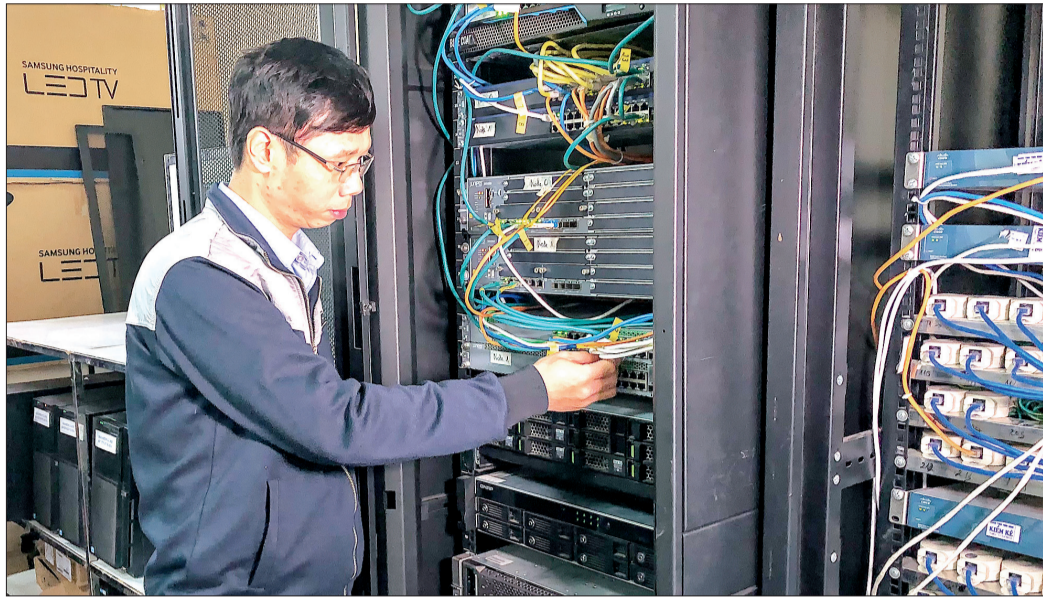
Cán bộ Phòng Công nghệ thông tin, Bảo hiểm xã hội tỉnh kiểm tra hệ thống trang thiết bị, bảo đảm giao dịch điện tử thông suốt.
