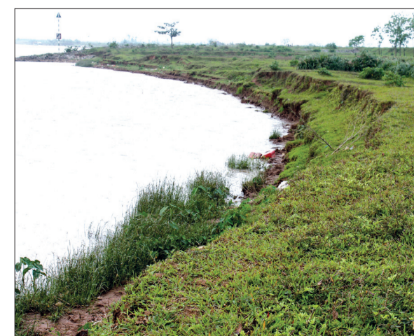
Đoạn bãi nằm giữa hai kè bảo vệ đê cũng bị sạt lở, lõm thành hình vòng cung.
