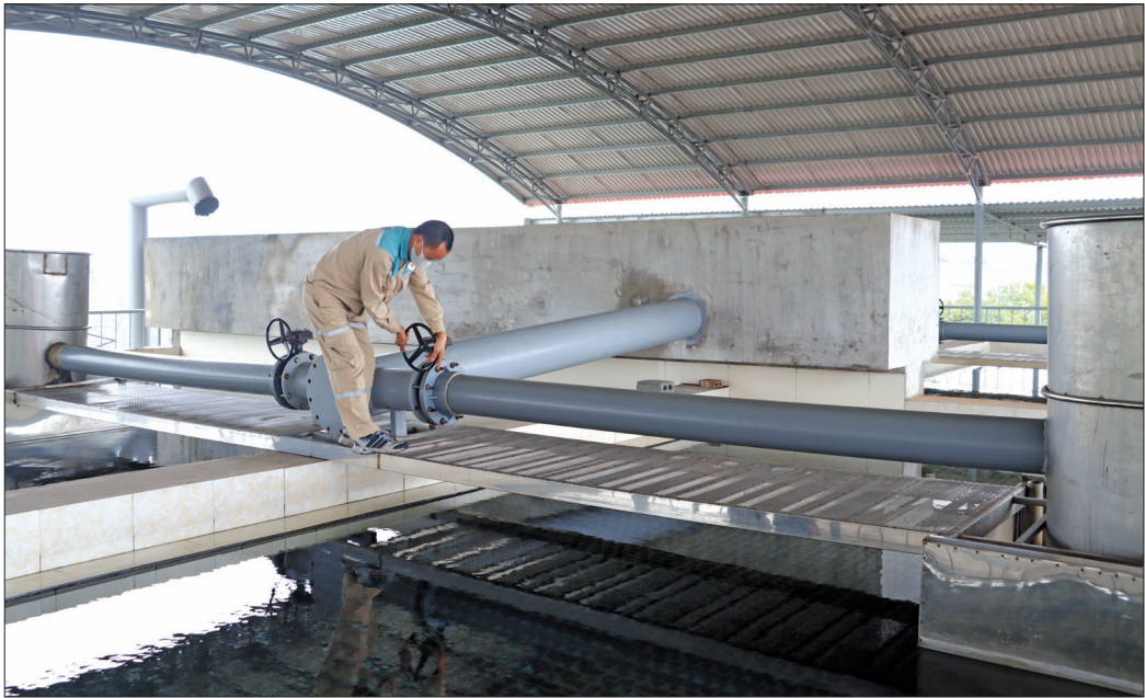
Nhà máy nước Phong Châu đầu tư nâng công suất, sử dụng máy móc hiện đại để đáp ứng nhu cầu nước sạch cho người dân vùng dự án.
