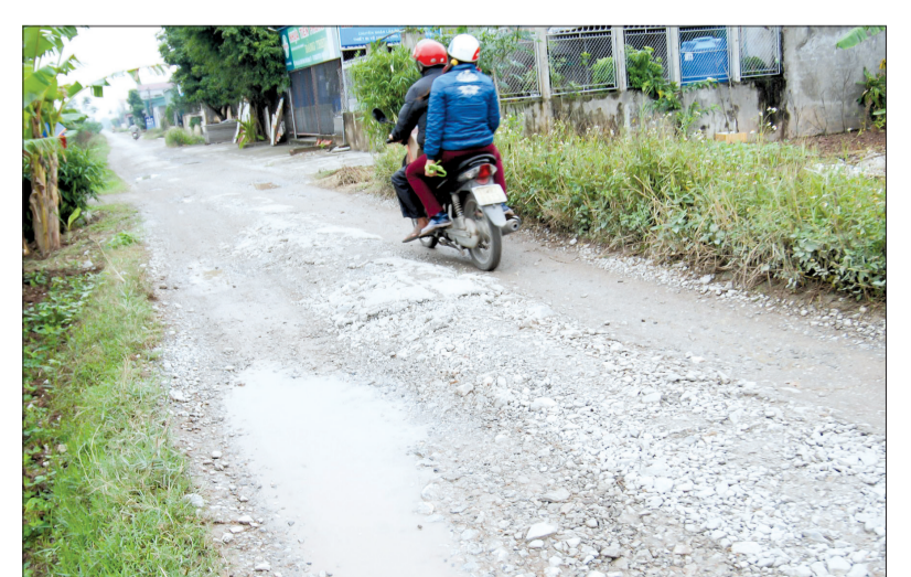
Mặt đường bị phá vỡ kết cấu, tạo hình sóng trâu, gây đọng nước.
