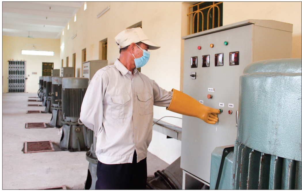
46 trạm và máy bơm của Công ty TNHH MTV Khai thác công trình thủy lợi Nam Thái Bình được bảo dưỡng phục vụ lấy nước vụ xuân năm 2022.
