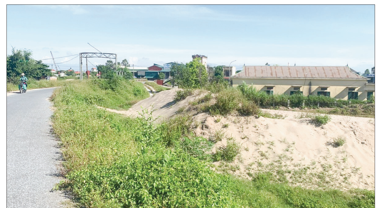
Chất thải cát ngay trên thân đê sông tả Trà Lý, thuộc địa bàn xã Thái Phúc (Thái Thụy).
