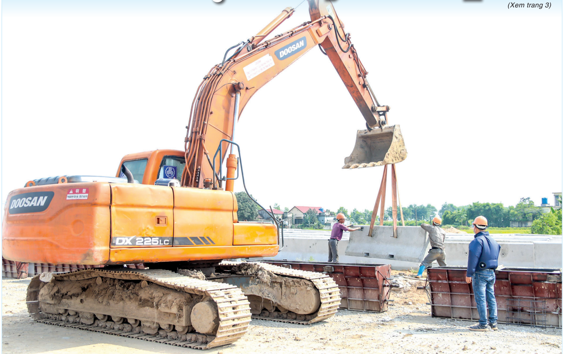
Đến nay, dự án đường vành đai phía Nam thành phố Thái Bình đoạn từ cầu gang S1 đến đường Chu Văn An kéo dài đã giải ngân đạt 48% kế hoạch. Trong ảnh: Thi công cầu kiện đúc sẵn trên tuyến đường thuộc dự án.
