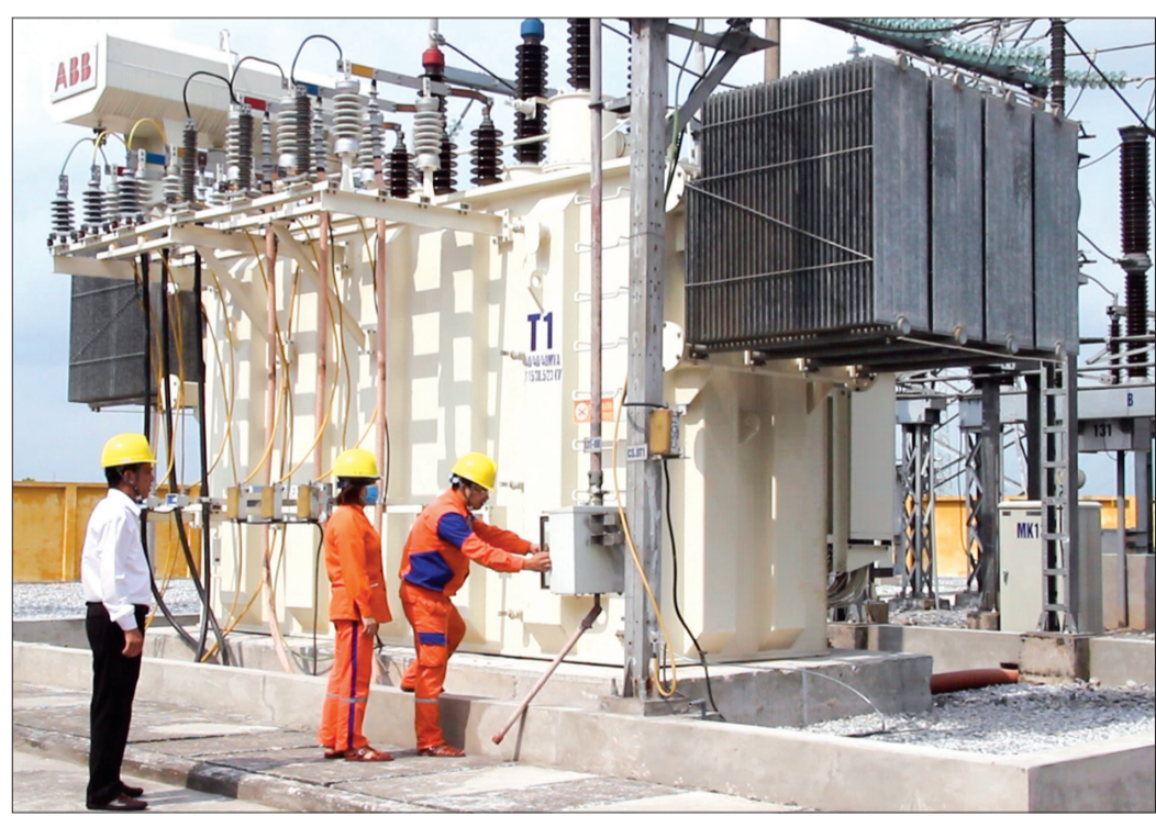
Điện lực Kiến Xương bảo đảm cấp điện ổn định, an toàn cho khách hàng.
