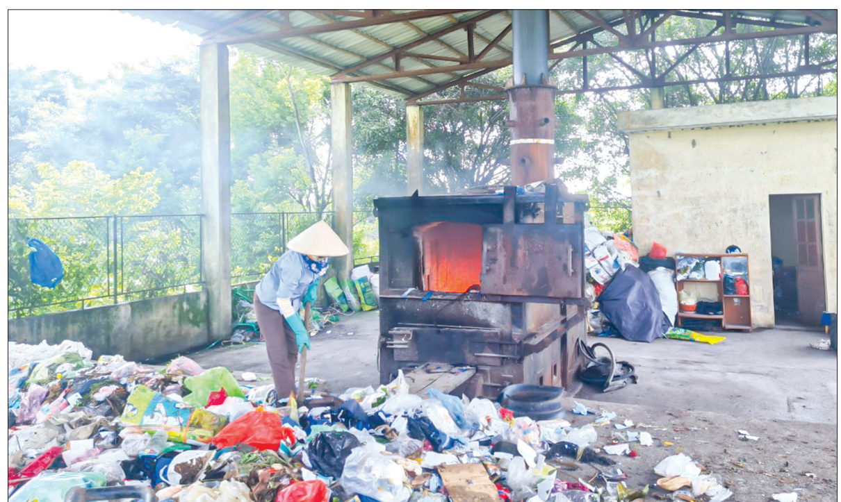
Lò đốt rác thị trấn Kiến Xương sau gần 10 năm vận hành đã xuống cấp, thường xuyên hư hỏng.
