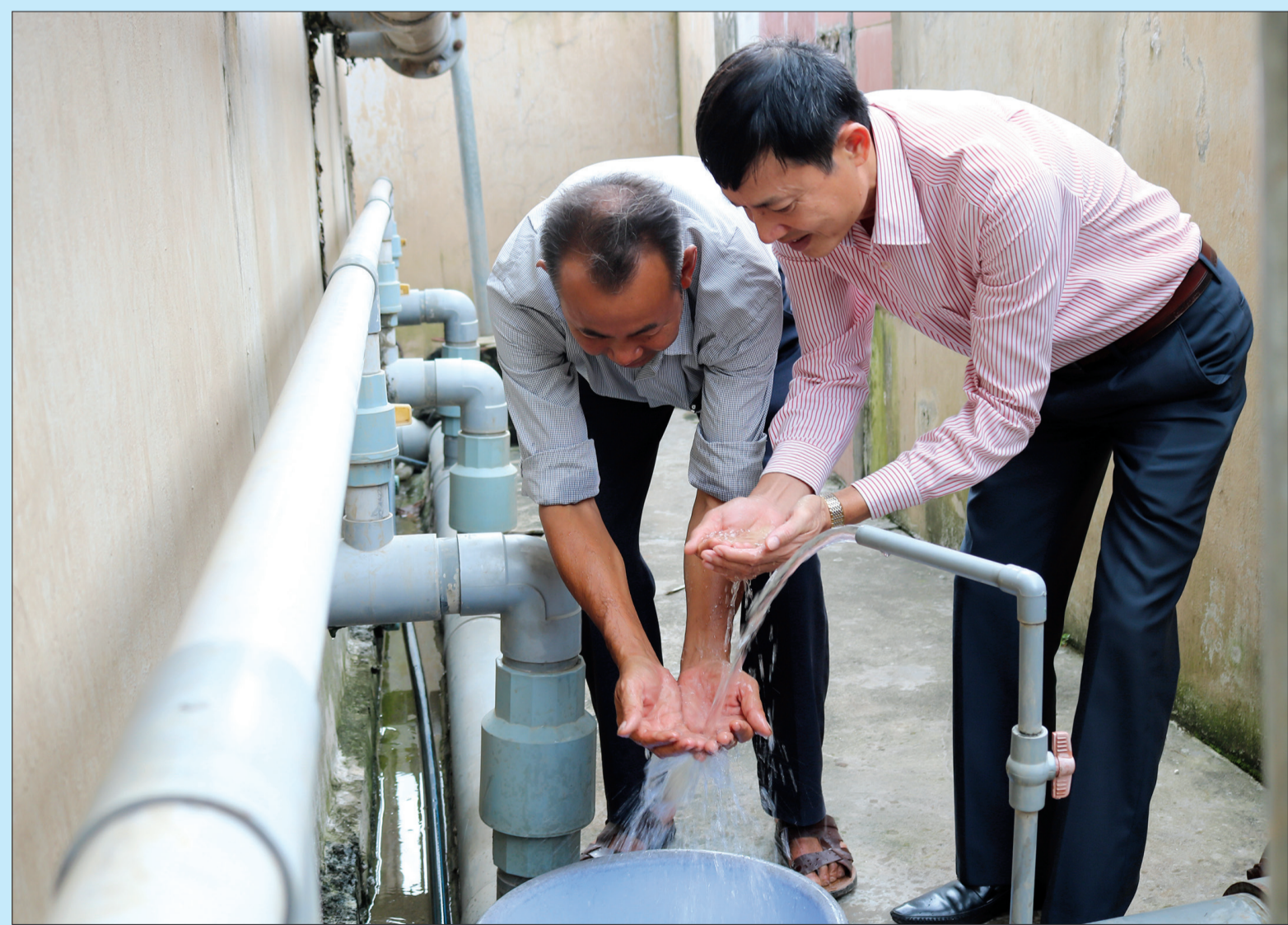
Nhà máy nước của Công ty TNHH Xây dựng Đoàn Trường Trọng.
